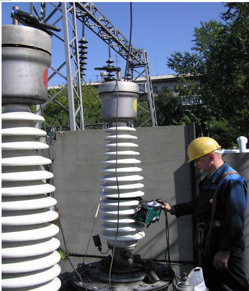
Рисунок 14 – Измерение прибором на крышке трансформатора
